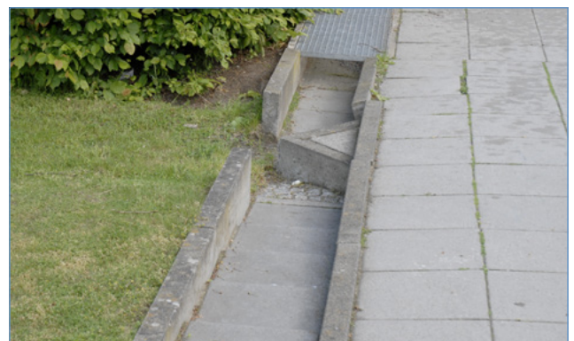
Abb. 10: Entwässerung über eine offene Kastenrinne
