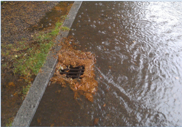
Abb. 6: Überflutung als Folge verstopfter Trummen
